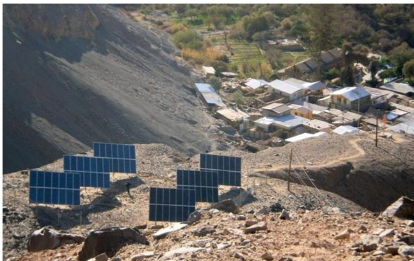
Figura N° 2 Planta solar fotovoltaica Huatacondo, 22,8 kW de potencia nominal.
